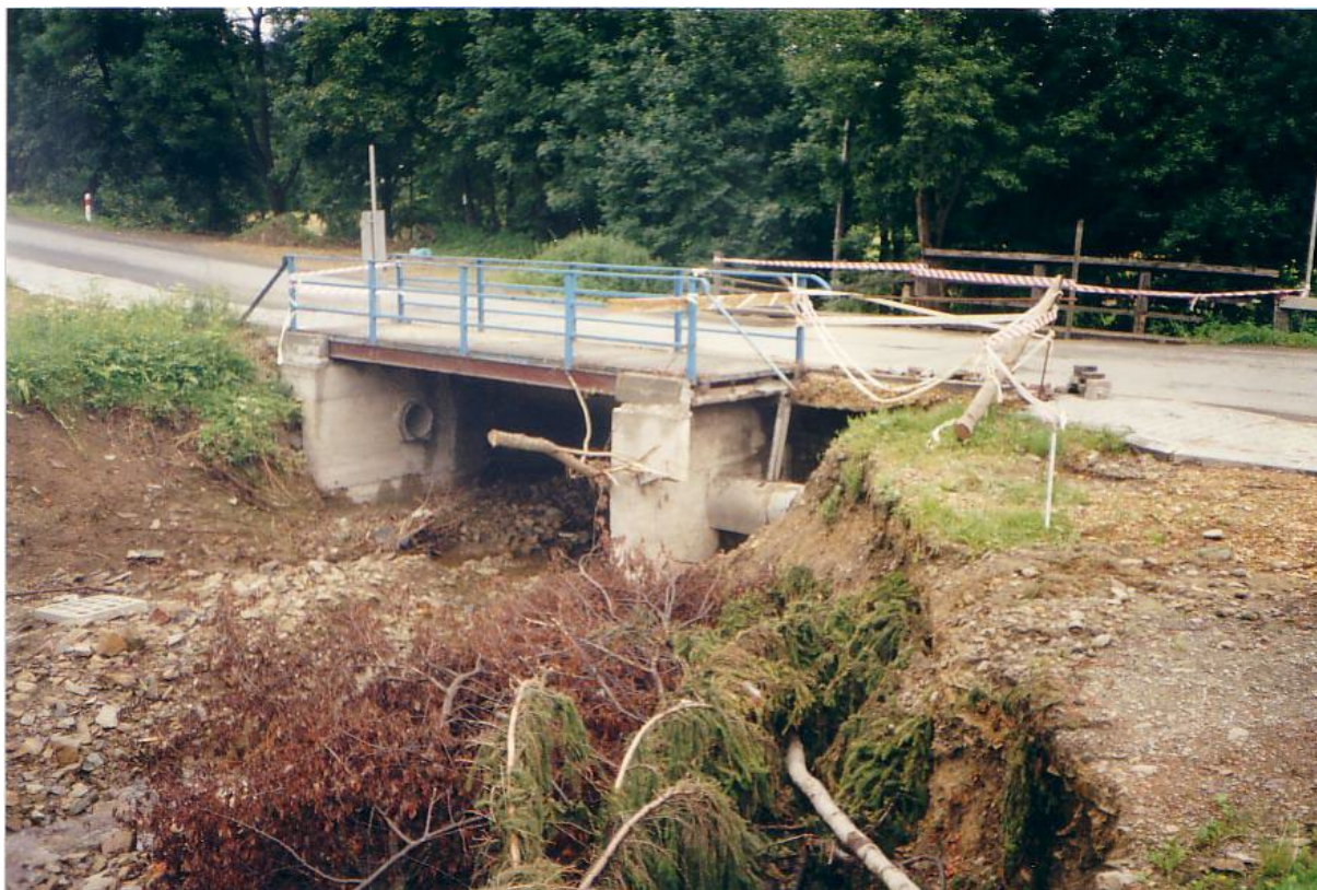
Fotografia 7. Widok zniszczonego przez powódź mostu w Baczyń
