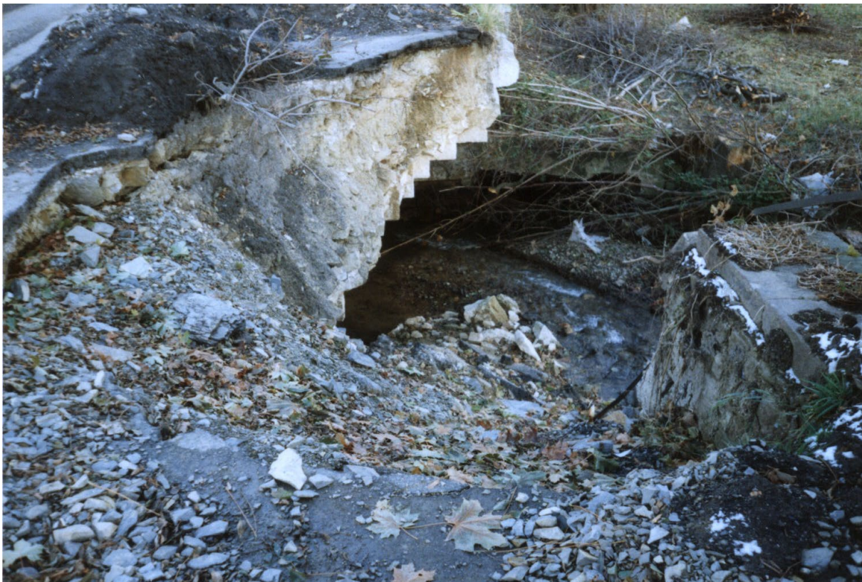
Fotografia 1. Widok zniszczonego przez powódź mostu w starym Waliszowie.
